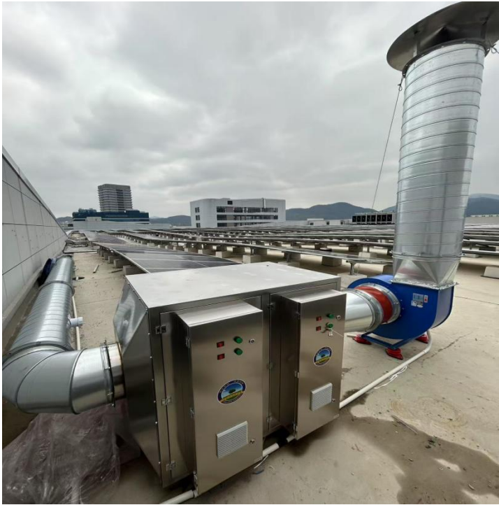
图 3-2 废气处理设施
